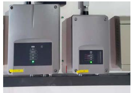
系统产品：SecuriSmoke ASD 53* / UMS 完工年份：2023年 项目类型：数据机房 项目名称：中国联通福州智·云数据中心
