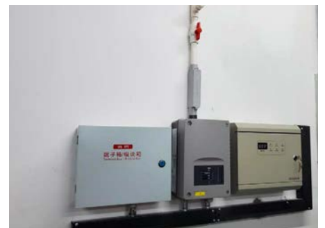
系统产品：SecuriSmoke ASD 53* / UMS 完工年份：2022年 项目类型：数据机房 项目名称：深圳互盟五联5G数据交换中心
