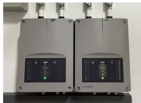
系统产品：SecuriSmoke ASD 53* / UMS 完工年份：2023年 项目类型：数据机房 项目名称：快手智能云乌兰察布数据中心
