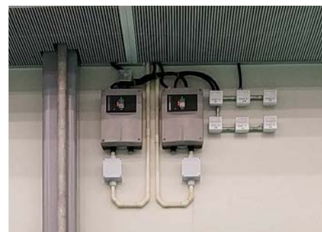
系统产品：SecuriSmoke ASD 535 完工年份：2017年 项目类型：洁净室 项目名称：康宁显示科技(重庆)有限公司
