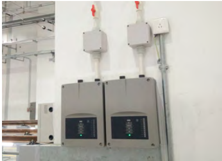
系统产品：SecuriSmoke ASD 535 完工年份：2017年 项目类型：地铁车库_车站 项目名称：上海地铁九号线
