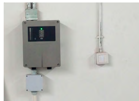
系统产品：SecuriSmoke ASD 535 完工年份：2022年 项目类型：车辆段 项目名称：佛山地铁2号线
