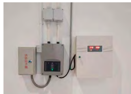
系统产品：SecuriSmoke ASD 535 完工年份：2018年 项目类型：物流仓库 项目名称：京东亚洲一号天府智能物流园
