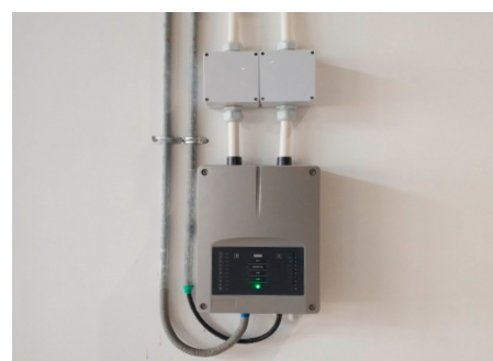
系统产品：SecuriSmoke ASD 535 完工年份：2018年 项目类型：物流仓库 项目名称：京东“亚洲一号”成都新都物流园
